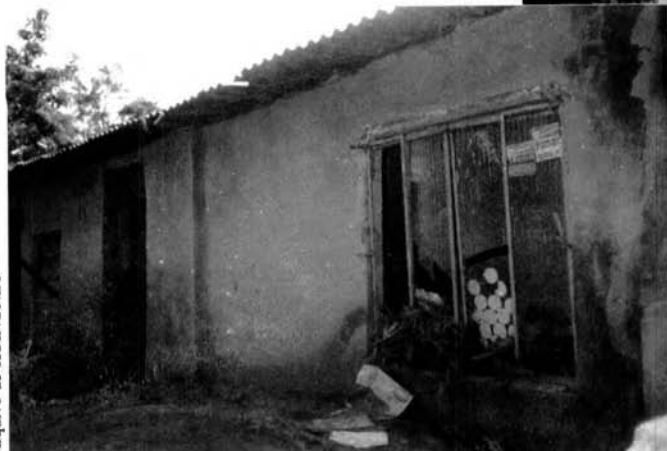
Casa da comunidade do Anil depois de atingida pelas chuvas de 1996
